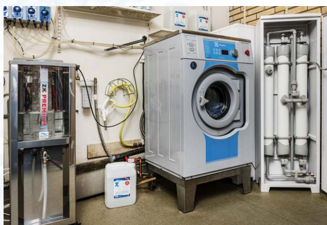
Till vänster i bild syns Z-Water Generator med vilken man tillverkar allt Z-Water lokalt i egna lokaler. Till höger syns den nyinstallerade filteranläggningen som gör att man klarar alla tvättbehov utan att använda tvättmedel.
